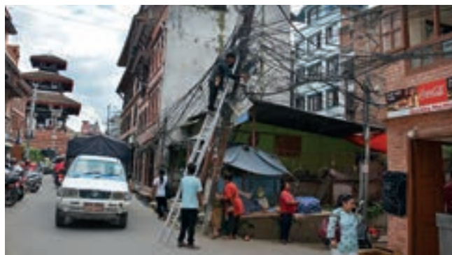
Trudno być elektrykiem w Katmandu...
